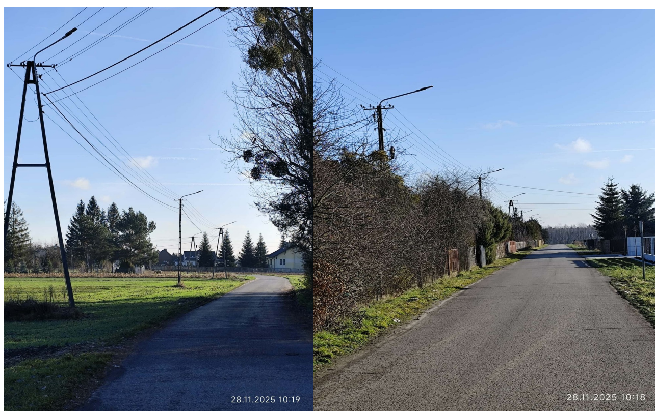
Realizacja zadania „Poprawa infrastruktury oświetlenia drogowego poprzez wymianę oświetlenia na energooszczędne w Gminie Pionki” w ramach programu „Mazowsze dla klimatu” – fot. baza własna
